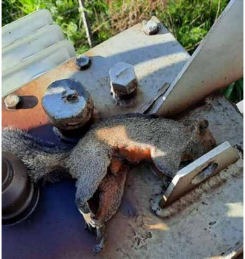
ELECTROCUTADA. Una ardilla encontrada en un fusible del tendido eléctrico.
